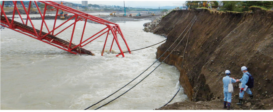
千曲川被災堤防調査
